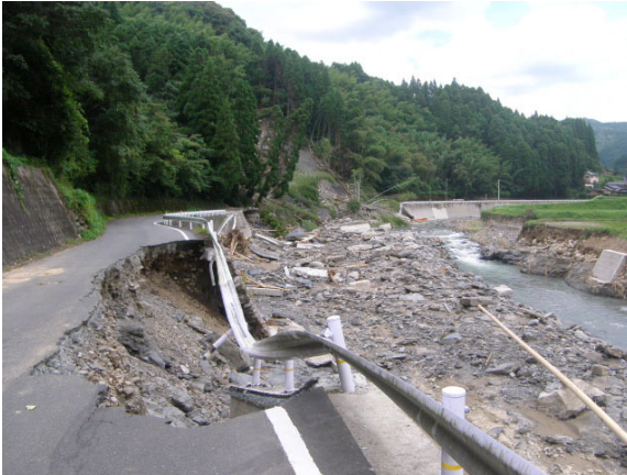
黒木町笠原地区の被災状況
