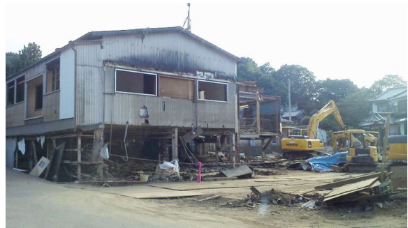
河川近くの被害のあった地区（竹田市拝田原）
